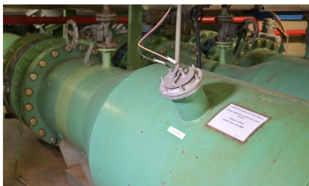
Umístění detektoru LAD-44 do jímky v měřeném potrubí
